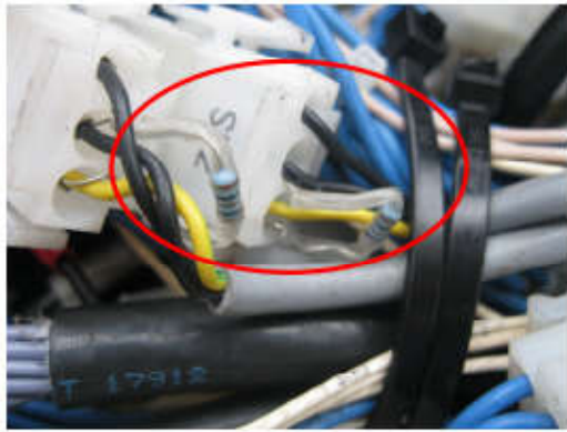
Resistencia de 301 Ohmios ¼ W 0,1% ( referencia 4000201370) Situadas en el interior del cuadro de mandos inferior en la parte inferior .
